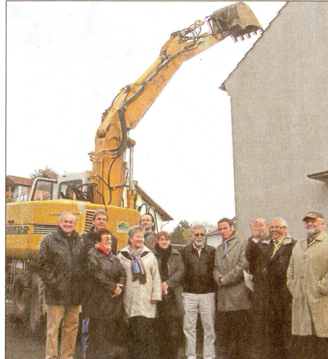
Vertreter der Bau- und Siedlungsgenossenschaft Laubach-Grünberg und der Stadt Laubach waren gestern zum Abriss des Hauses in der Gießener Straße gekommen. Fotos: Hogen-Ostlender
