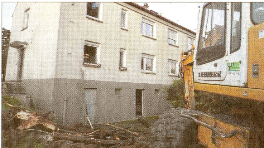
So sah es gestern nach Feierabend aus. Am ersten Arbeitstag wurde mit dem Bagger erst einmal der Garten hinter dem Haus vom Bewuchs freigeräumt.
