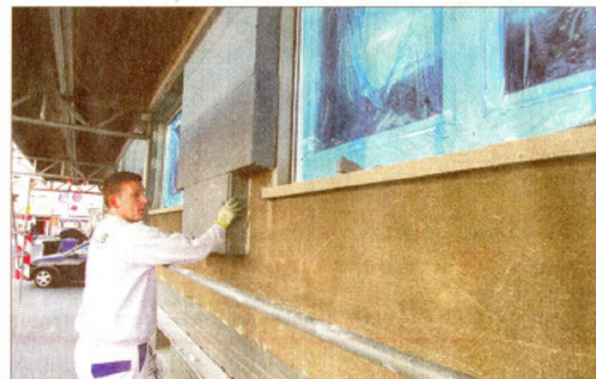
Entspricht die Dämmung der Energieeinsparverordnung, darf sie wie hier in Gießen - in den Gehweg hineinreichen. (Foto: Kächler)
