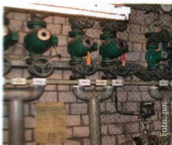
Ungenutztes Sparpotential: die Pumpen!
